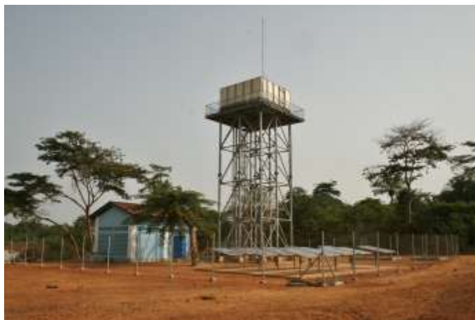
Vattentornet med solcellerna
